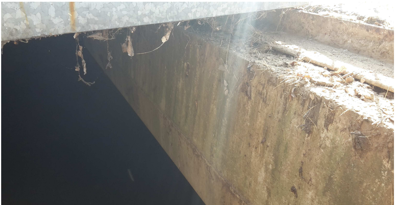
Foto n°2 – fianco trave prefabbricata a T, lato destro
